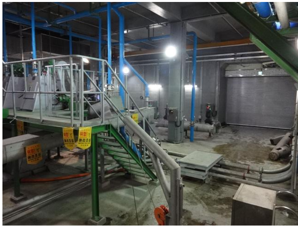
침사지 및 협잡물 처리시설
